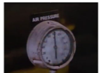
Verifica, em seguida, que a pressão interna da tubulação pode ser ajustada.
